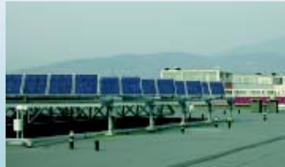
Vista dell'impianto e dei quadri di campo
