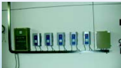
I 5 inverter posti nel locale tecnico
