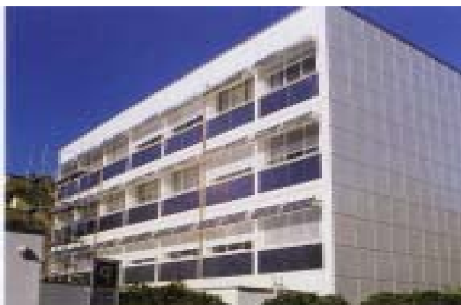
Balconi rivestiti di moduli FV in due alberghi
